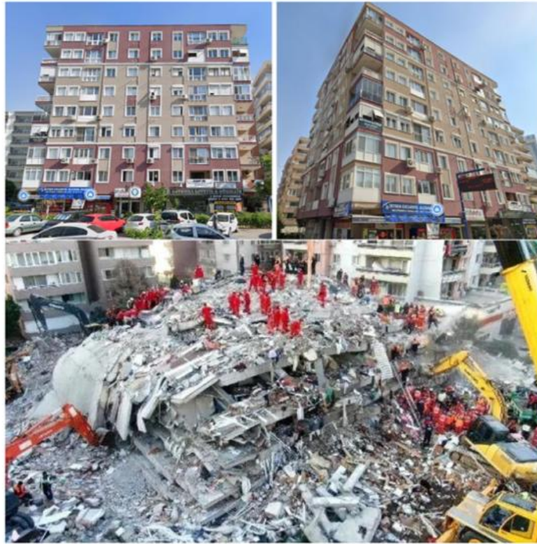
Görsel 12: Yıkılan Rızabey Apartmanı [9]
